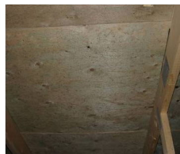
Bild 23 Mikrobiell påväxt på några år gamla underlagstak över välventilerade vindsutrymmen utan "felutförande".
