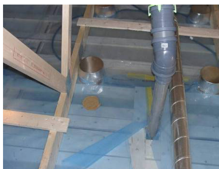
Bild 20. Stora brister i foliens lufttätet mot genomföringar. Isolering kan ej ske!
