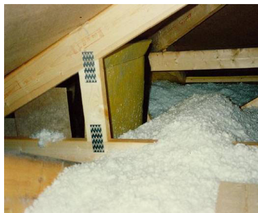
Bild 17. Konsekvensen av bristfälligt lufttät anslutning mellan avstängare och hammarband vilket innebär att isoleringen blåser undan.
