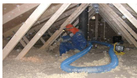
Bild 18. Efter isoleringen är det betydligt mer svåråtkomligt för korrigerande åtgärder!
