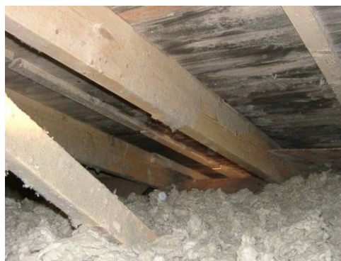
Bild 21. Påtagliga fuktskador efter ca 1 år pga bristfällig ventilation inne.
