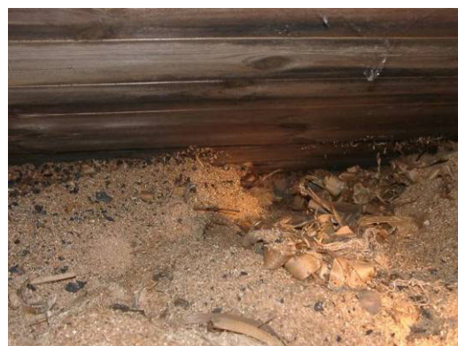
Bild 7. Tecken på uppträngande fuktig inomhusluft som kondenserar mot underlagstaketets kalla yta.
