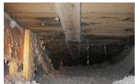
Bild 15. Efter ett par år har skadorna blivit mer omfattande och utbyte av delar av underlagstaket kan bli aktuellt.
