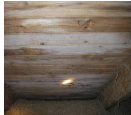
Bild 14. Missfärgningar som uppkommit efter tilläggsisolering. Upptäcks fuktutfällningen tidigt kan åtgärder göras utan att omfattande skador hinner uppstå. Primärorsaken till skadan är ett otätt vindsbjälklag i kombination ett invändigt övertryck som innebär att fuktig inneluft tillförs vindsutrymmet.
